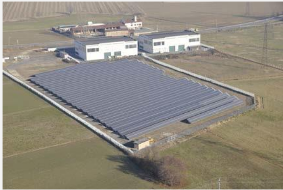
L'impianto di Volpiano (To)
